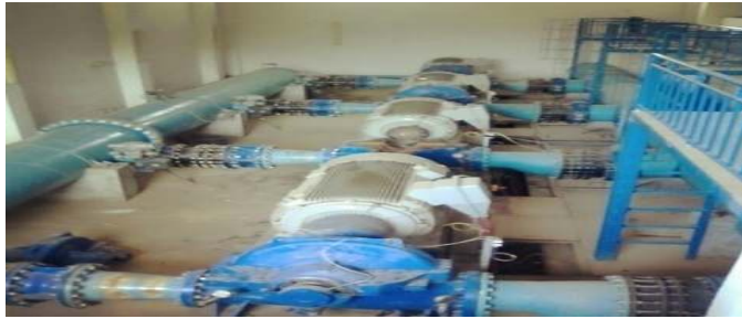
Photos 11 : La station de pompage numéro 1
