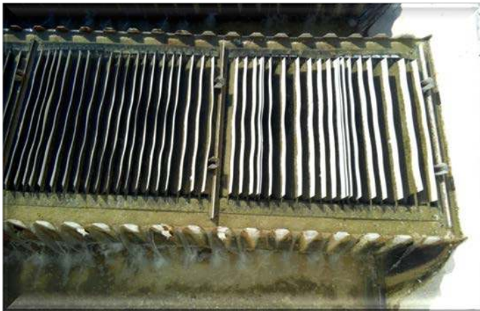
Photos 21 : Décantation lamellaire
