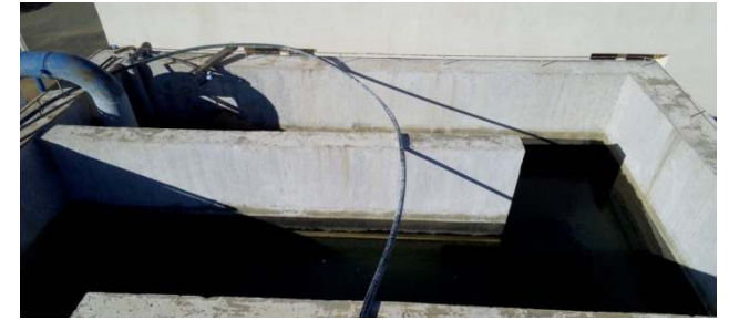
Photos 13 : le circuit d'eau dans les chaines
