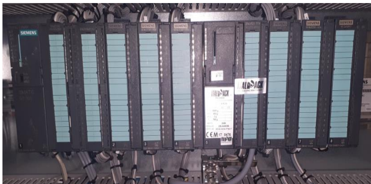
Figure IV.40 : s7-300 dans l'armoire
