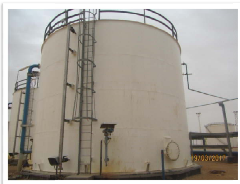
Figure III.19 : Réservoirs tampons d'eau produite.
