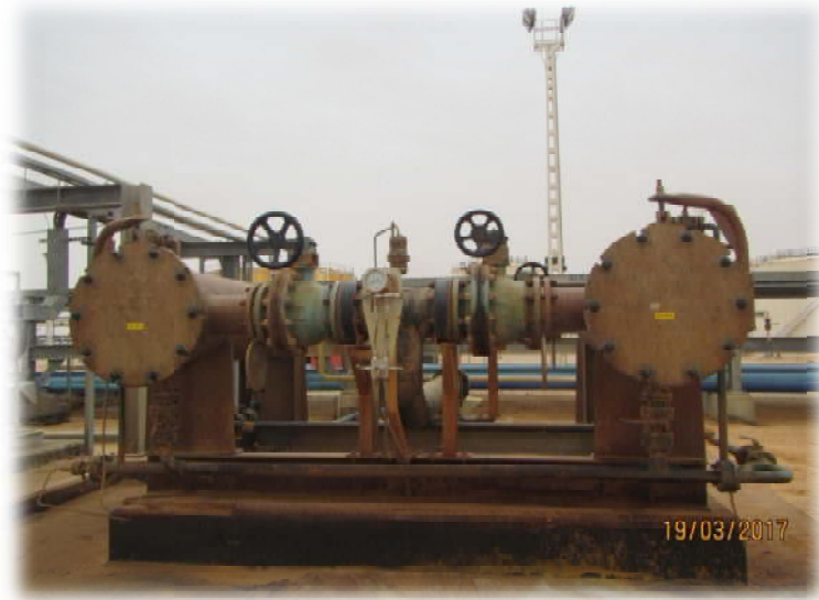
Figure III.21.a : les filtres d'eau produite.
