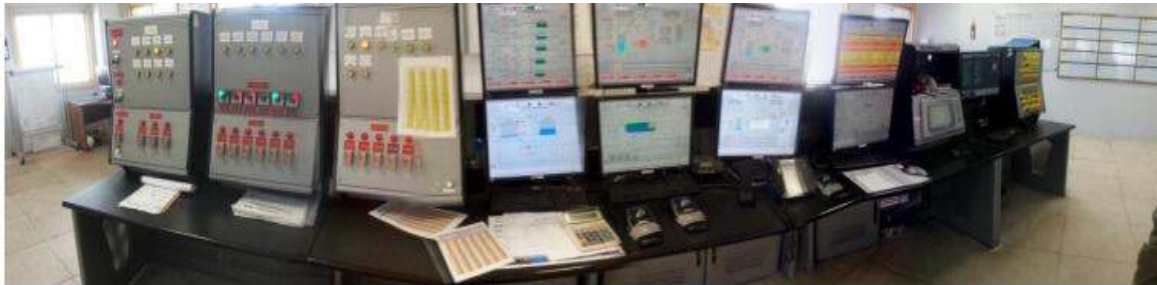
Figure II.8 : la salle contrôle de GS1 [14] .
