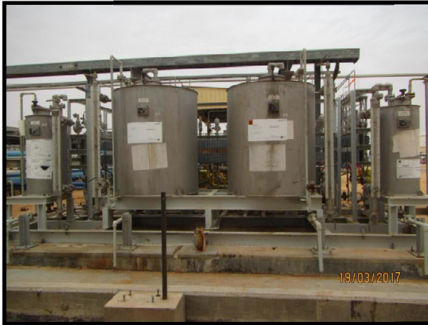
Figure III.22 : Les skids d'injection de produits chimiques.
