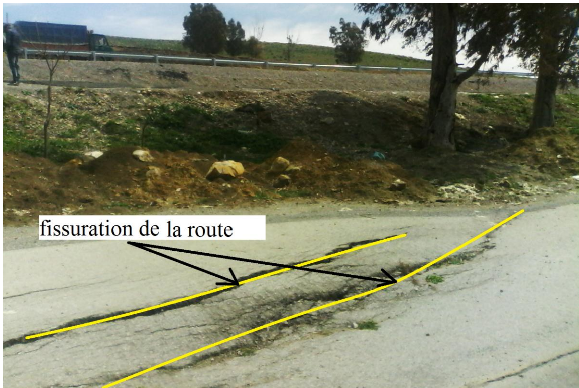
Fig.VI.3 : Fissuration de la chaussée de la route (RN 10)
