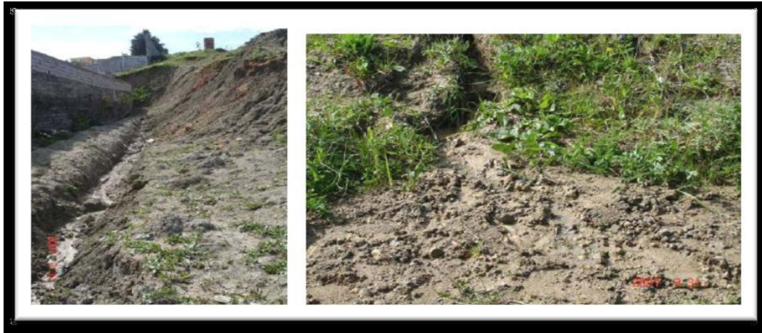
Fig.IV.21 : Alimentation en eau de la zone glissée par ruissellement à partir des eaux stagnées en amont. Source : ARAB R.; 2009.
