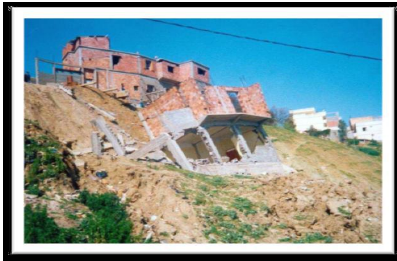
Fig.IV.24 : Glissement de Tizi quartier de Bejaia. basculement d'une habitation.
