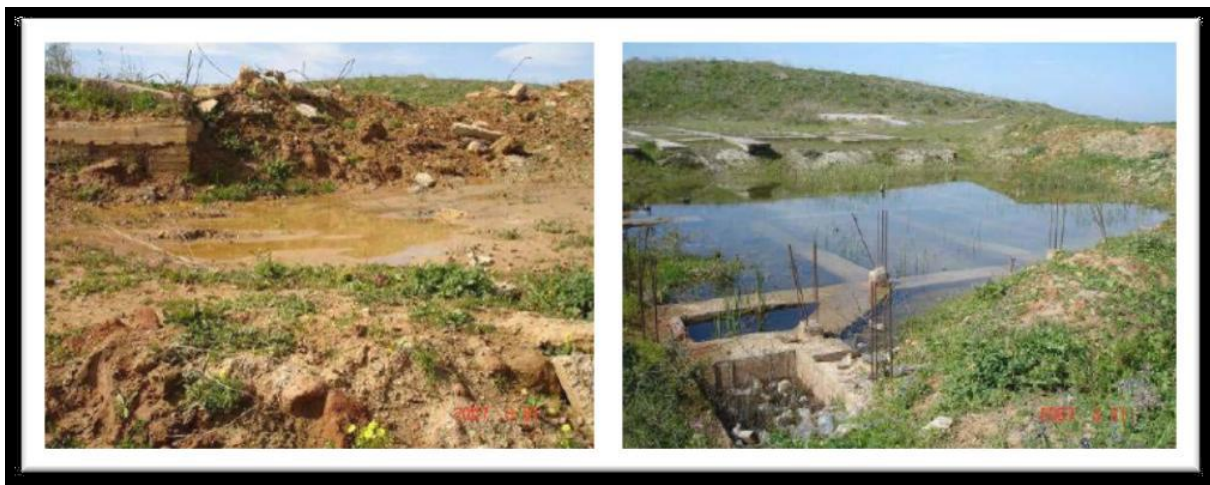
Fig.IV.20 : Stagnation des eaux en amont dans des fondations abandonnées.
