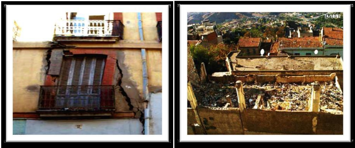
Fig.IV.25 : Glissement de terrain à Belouizdad. [2002].
