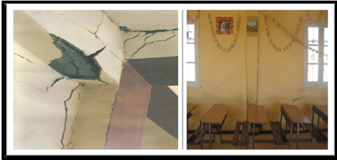
Fig.IV.23 : fissuration des poutres et des murs à Ain Hadjel.
