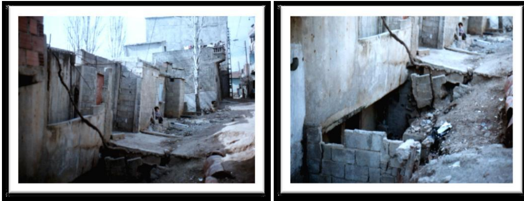
Fig.IV.26 : Vue partielle d'un alignement de constructions ayant subi des basculements à Boudraa Salah.
