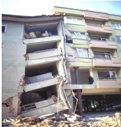
Figure I. 10: Martèlement et effondrement.
