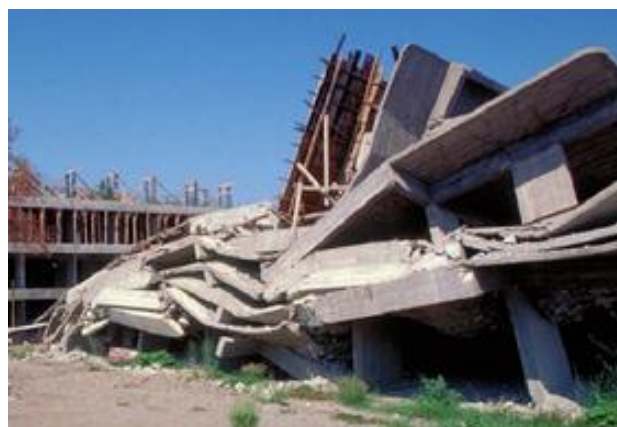
Figure I. 11 : Effondrement d'un bâtiment sous forme d'une galette.
