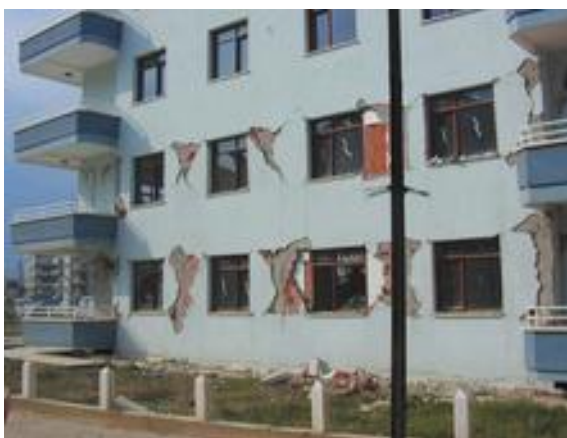
Figure I. 12 : Fissures en croix.
