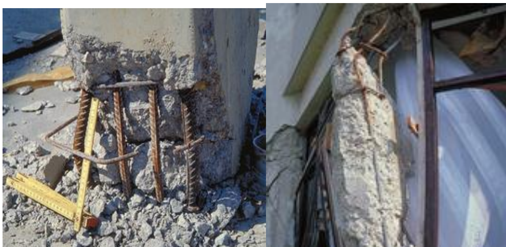
Figure I. 15: déficient de l'armature transversale(a) et Flambage de l'armature longitudinale a la base de voile(b).
