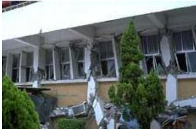
Figure I. 14 : Dommages dus à l'effet de poteau court (séismes d'El Asnam, Algérie 1980).
