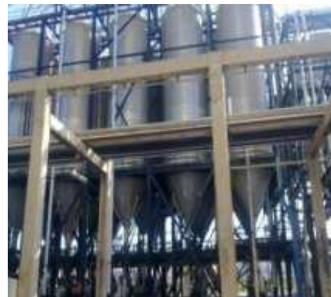
Figure V. 22: Silos de stockage des granulés
