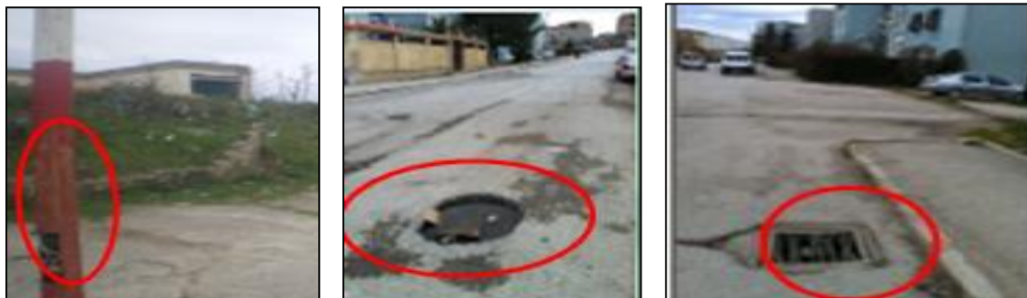
Photo 19 : Etat de candélabres et chaussée dans le quartier Chaabani.
