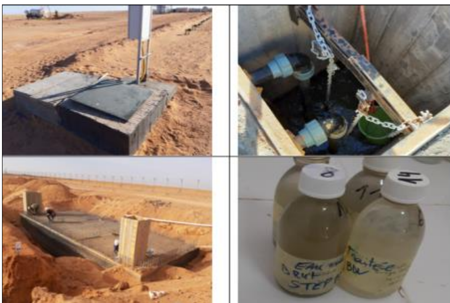
Figure II.22 : Réservoir des eaux traitées
